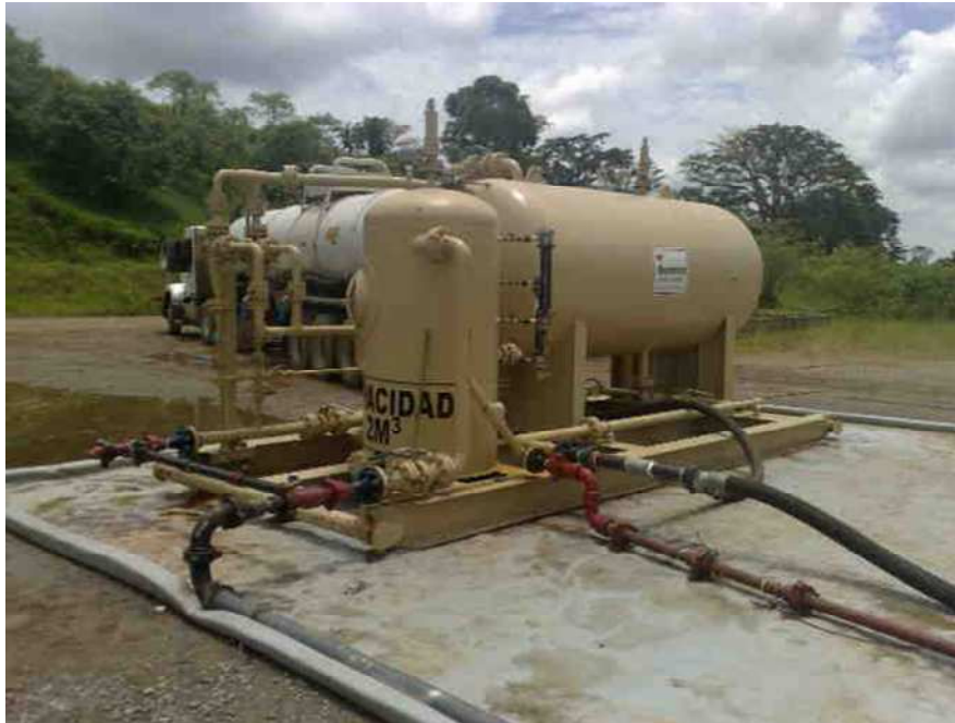
Figura 3.35. Sistema Dual-Vessel instalado en el Pozo Secadero 1001.
