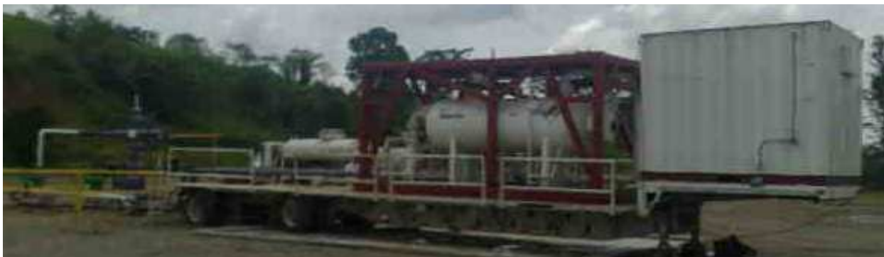
Figura 3.36. Instalación Superficial con el Separador de Alta Presión en el Pozo Secadero 1001.
