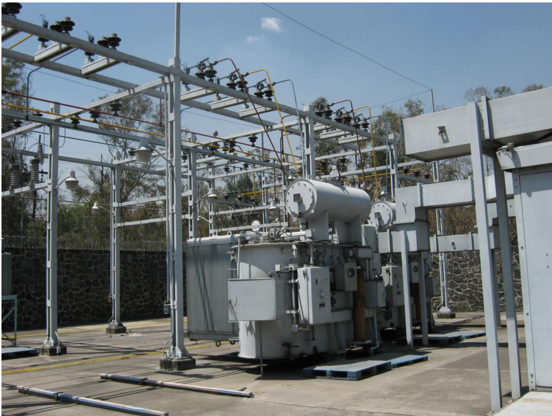
Fig. 4.1 Transformador ubicado en la SG1 del Campus Universitario de la UNAM.
