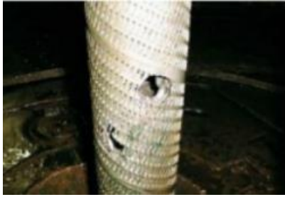
Figura 3.14. Erosión de tubería causada por arenamiento
