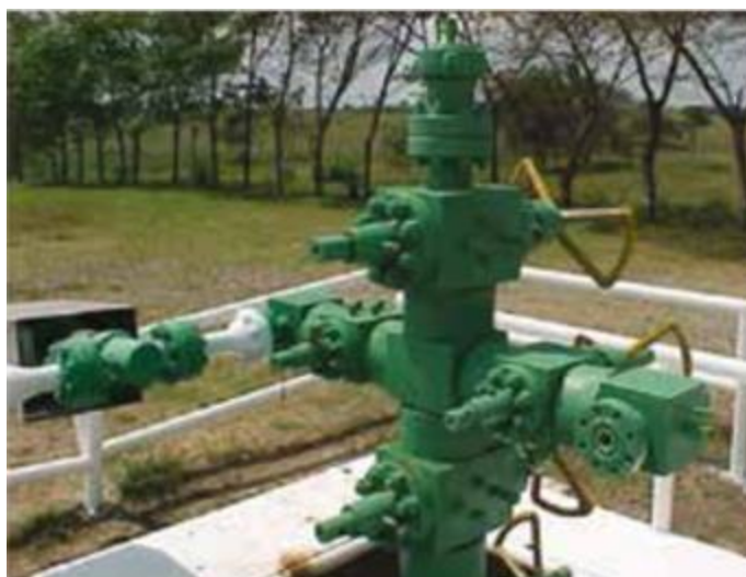
Figura 2. 6. Árbol de válvulas.
