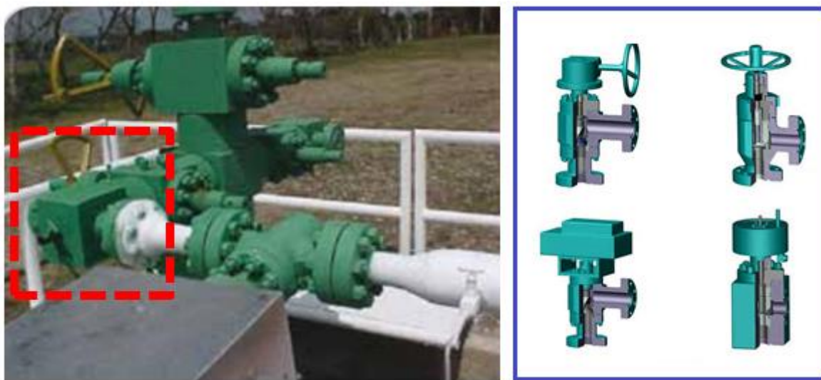
Figura 2. 7. Estrangulador en boca de pozo.
