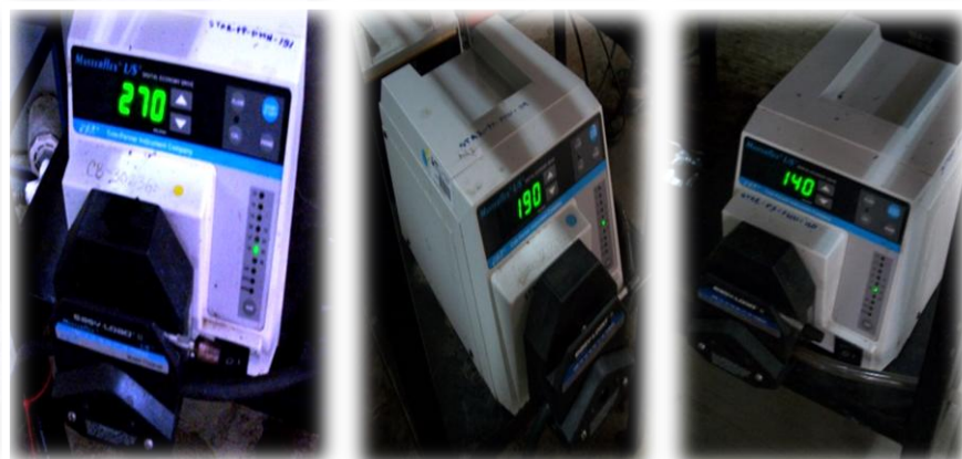
Foto 3.3 Bombas utilizadas para la recirculación en el R1, R2 y R3.
