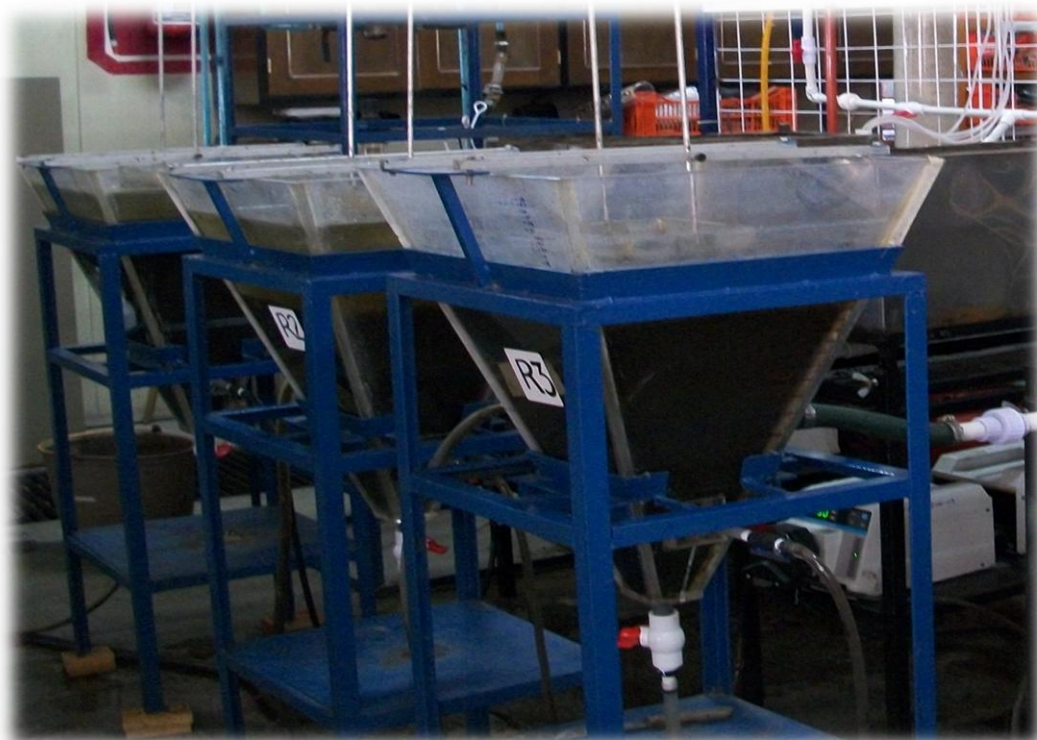
Foto 4.1. Vista lateral de los sedimentadores secundarios.
