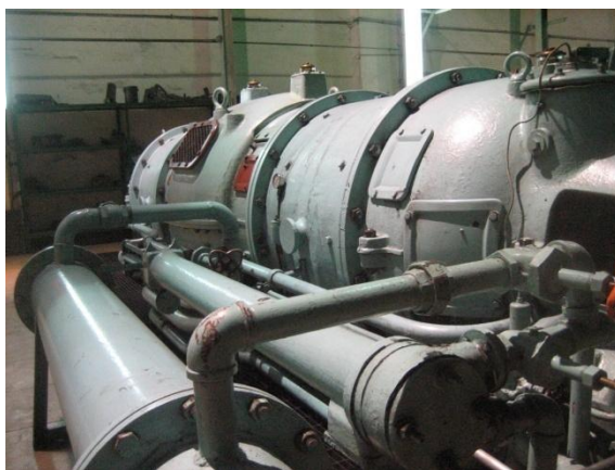
Figura 6: Generador de energía eléctrica
