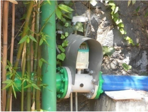
Figura AII.5 Medidor de caudal del influente
