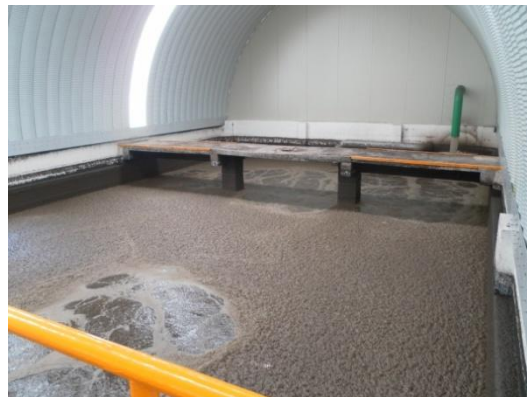
Figura 3.4 Tanque de lodos activados.
