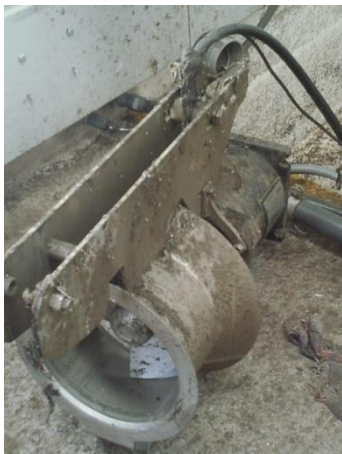
Figura AI.11 Bomba de alimentación del tanque de membranas.
