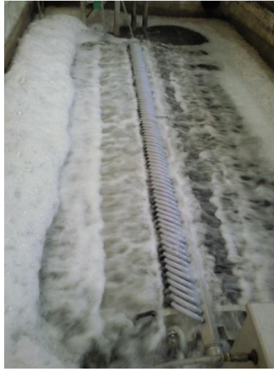
Figura 4.23 Limpieza química la unidad de membranas.
