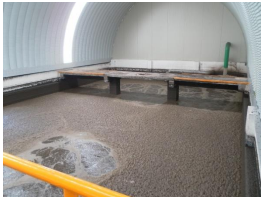
Figura AI.9 Tanque de aireación.
