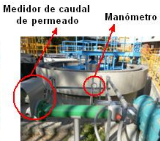
Figura AII.2 Medición de caudal y de presión negativa
