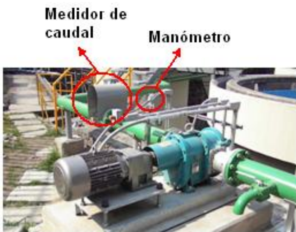
Figura AII.1 Medición de caudal y de presión negativa
