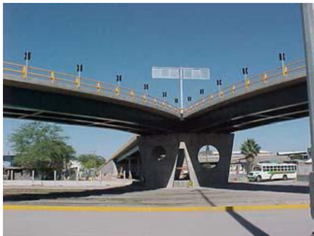
ILUSTRACIÓN 7: PASO A DESNIVEL EN TORREÓN. INTERSECCIÓN ENTRE AVENIDA Y LA LÍNEA A.
