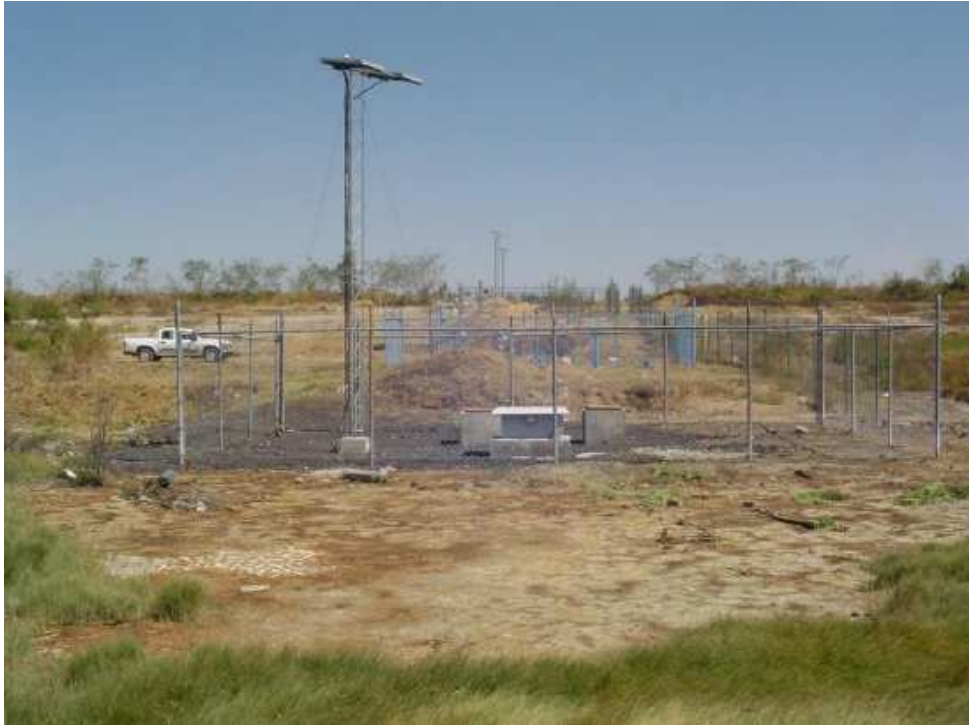
Figura 4.45 Estación ERS-3 vista desde campo libre
