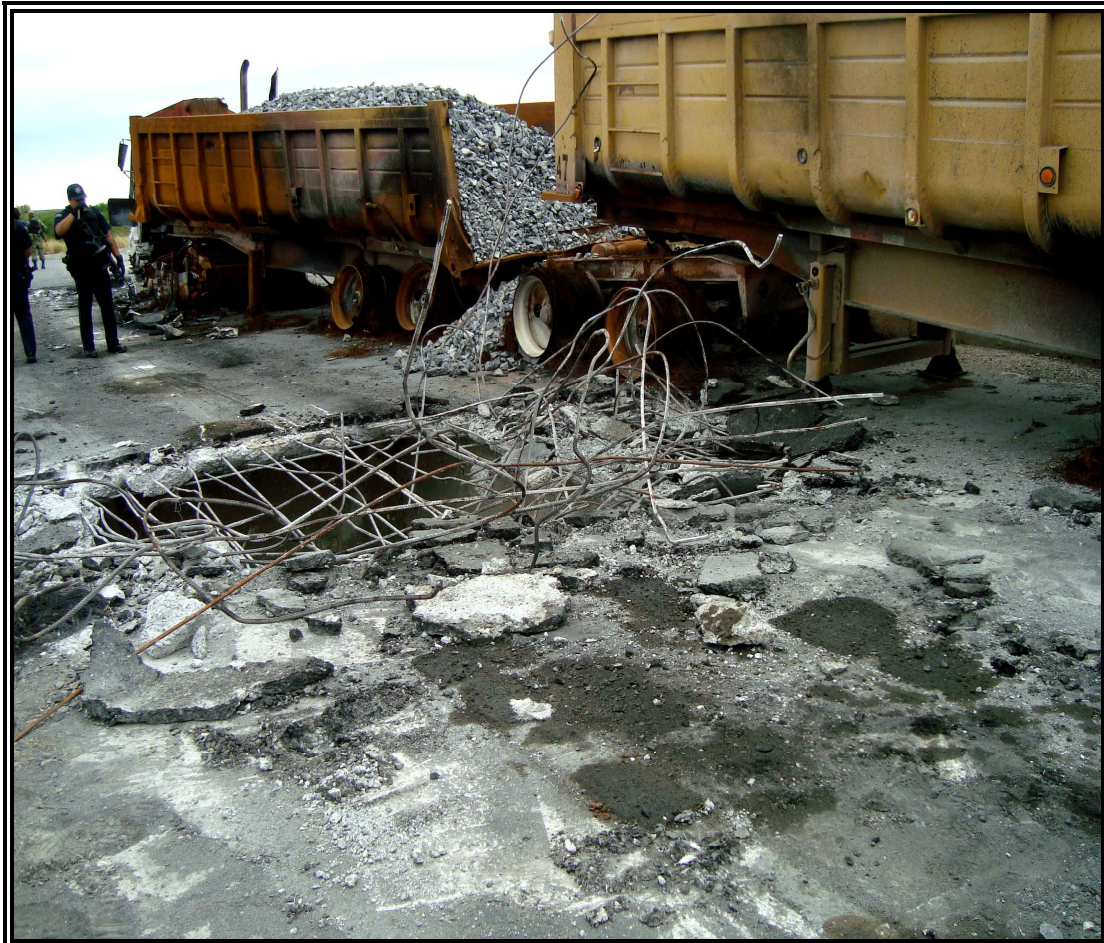
ASPECTO GENERAL DEL BOQUETE REALIZADO SOBRE EL PUENTE VEHICULAR A LA ALTURA DEL POBLADO SAN ANTONIO DE REYNA
