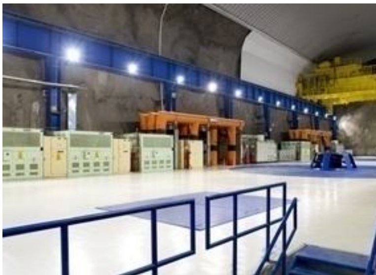
Imagen 19.- C.H. El Cajón, Estado de Nayarit. Casa de máquinas en caverna
