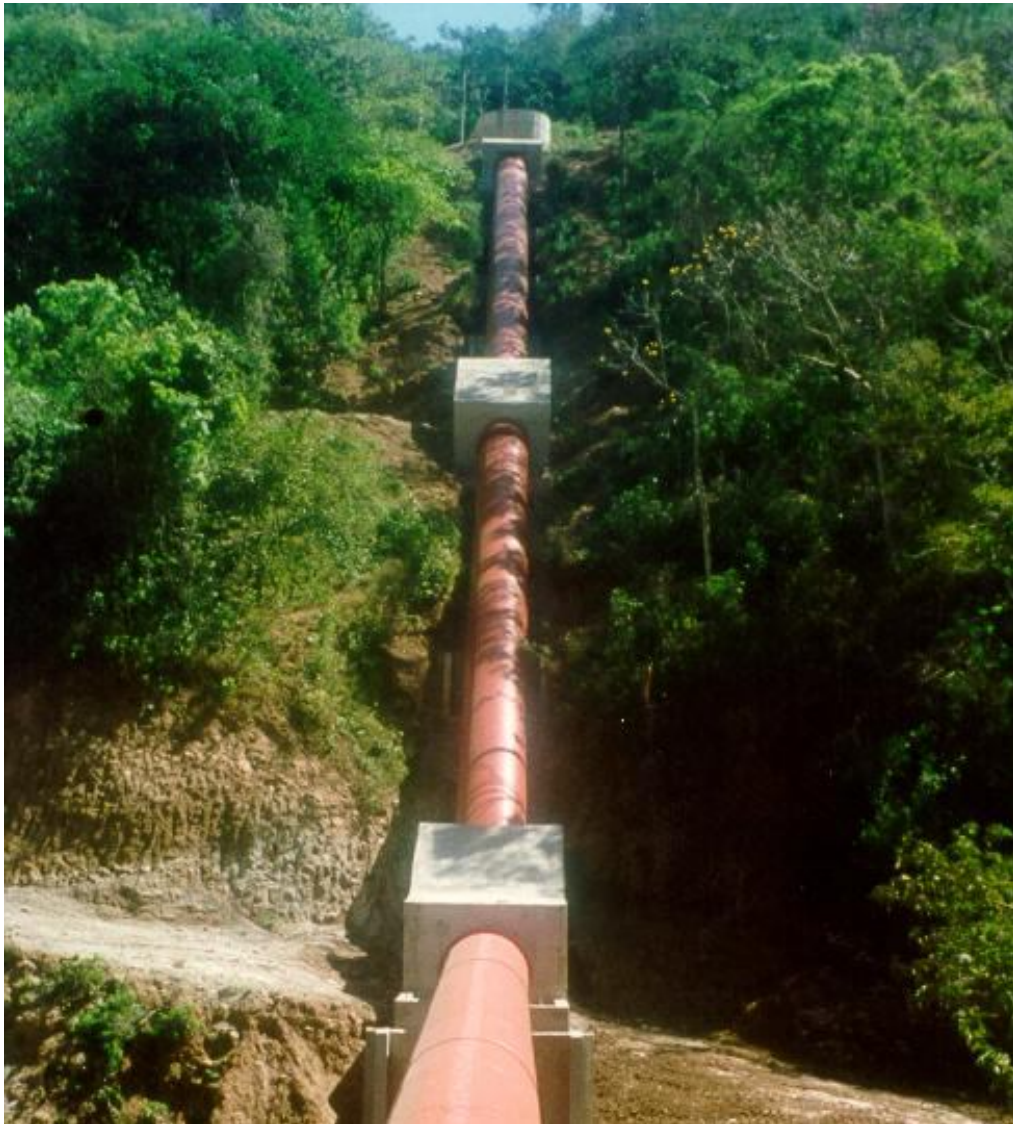
Imagen 17.- Tubería a presión libre al exterior
