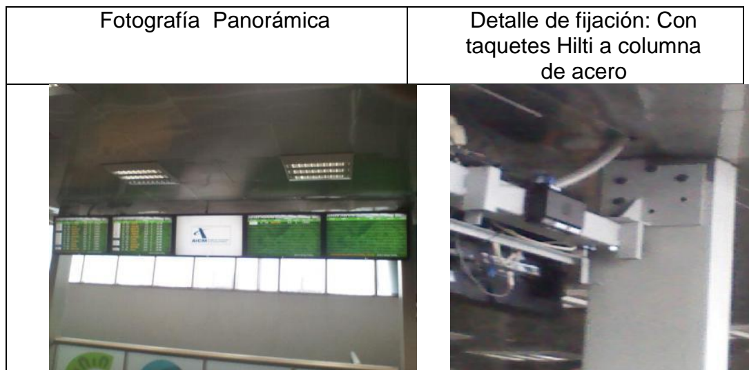
Figura 3.19. Montaje especial del soporte larguero para 5 pantallas. La columna es de acero, por lo que se usaron tornillería de alta resistencia con rondanas planas y de presión, así como tuercas inoxidable.
