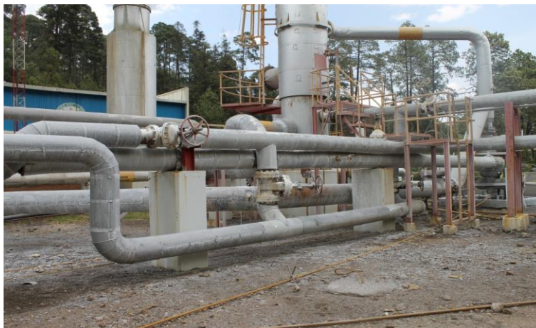
Figura 24.- Tuberías para el transporte de fluidos geotérmicos, Los azufres CFE (El autor)
