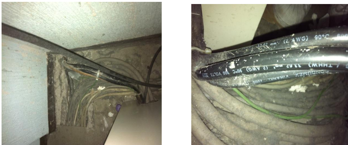
Figura 2.10 Conductores eléctricos para el generador de rayos X.
