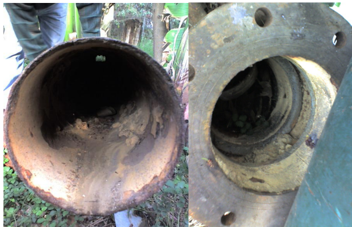
Figura 27. Incrustaciones en las tuberías de agua potable
