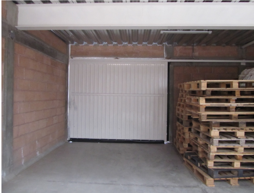
La puerta de recepción de producto se sello con plástico para evitar intrusión de roedores
