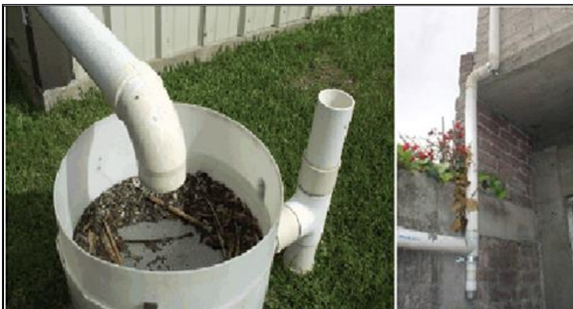
Figura 3.13 Trampa de basura para las primeras lluvias (izquierda) y válvula para drenaje (derecha) (Hernández, 2009)
