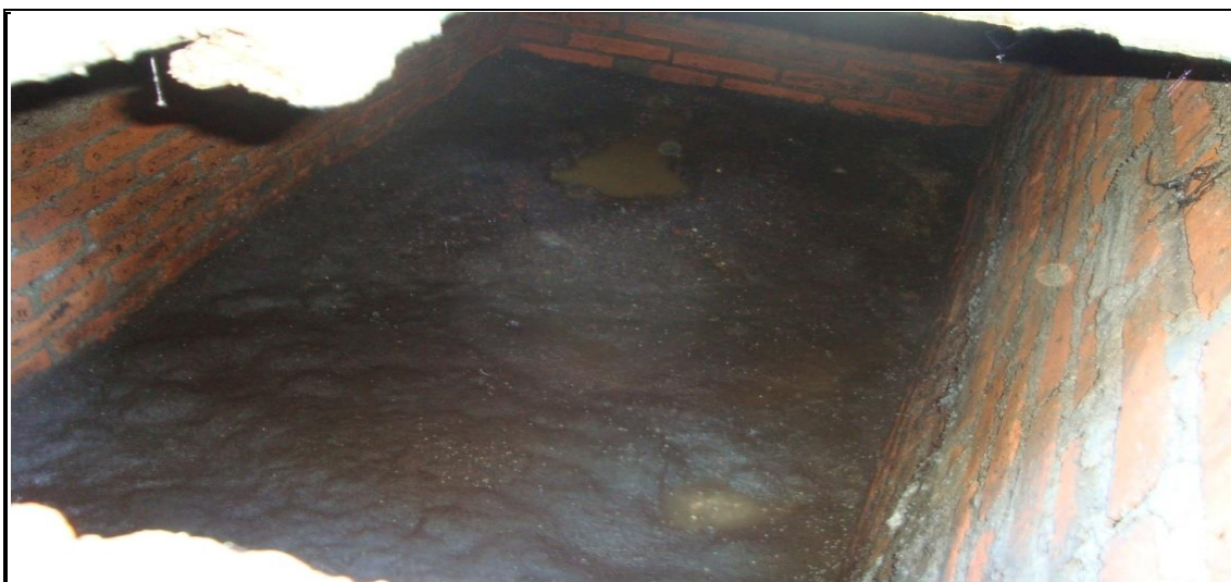
Figura 5.46 Fotografía fosa séptica de la casa en estudio (interior)
