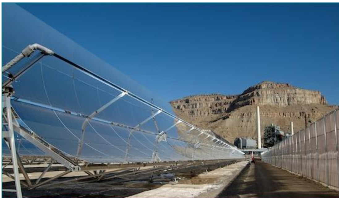
Figura 3.5 Arreglo cilindro parabólico. Palisades, Colorado (NREL)
