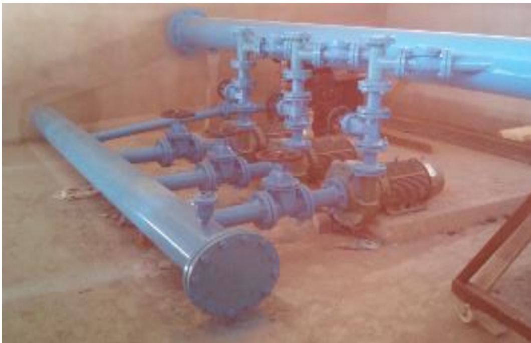
FOTO 4. Bombas del Sistema de velocidad variable
