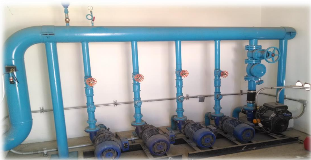
FIGURA 3.5 EQUIPO DE BOMBEO MEDIANTE UN SISTEMA DE VELOCIDAD VARIABLE
