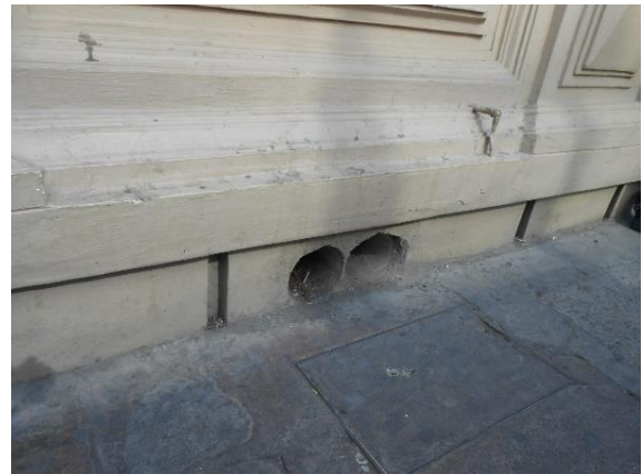
Ilustración 29. Descarga de la red pluvial.
