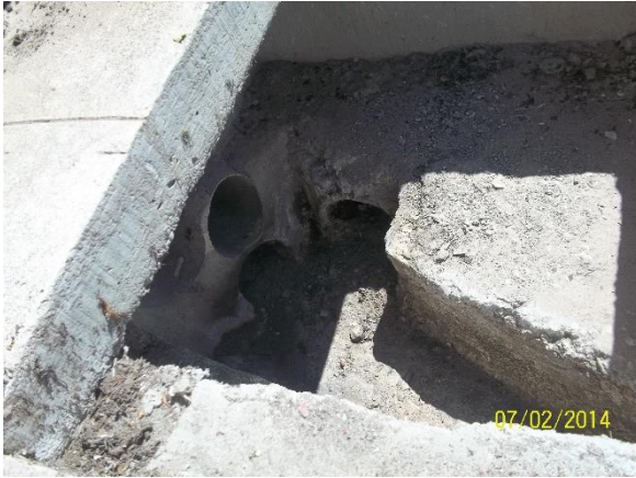
Ilustración 26. Tuberías en el registro No. 5.
