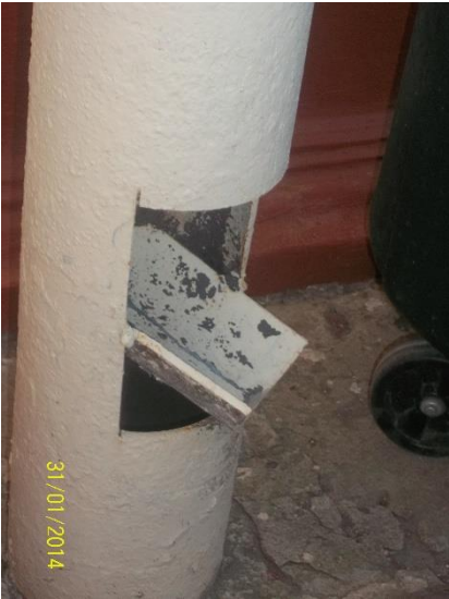
Ilustración 5. Corte en la tubería de bajada.
