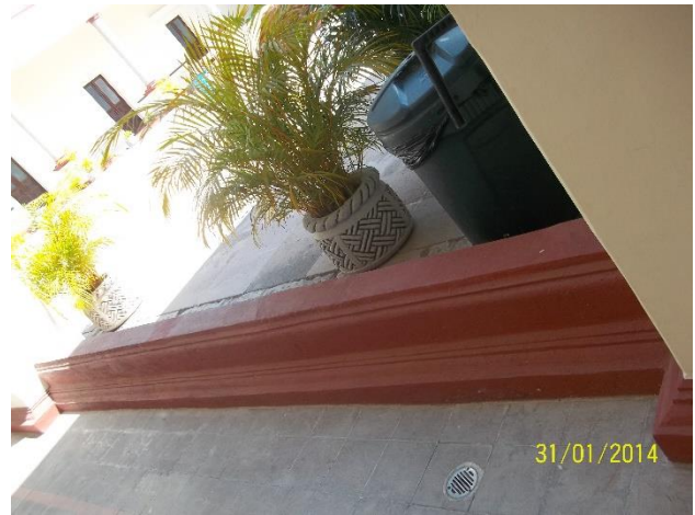
Ilustración 20. Pretil en pasillo.
