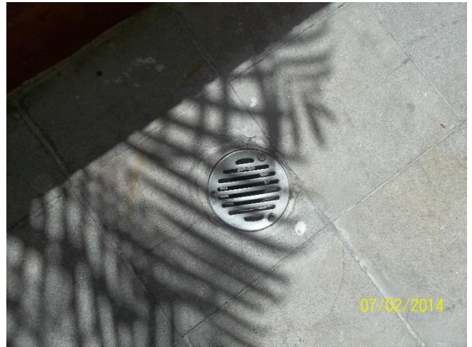
Ilustración 7. Coladera de pasillo.
