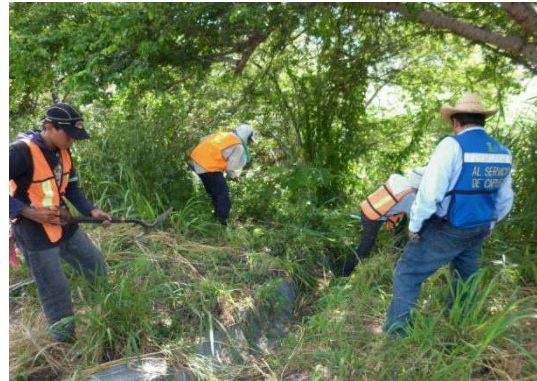
Fotografía No.61. Se observa a personal de la contratista realizando la limpieza y desazolve de lavaderos.
