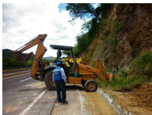
Fotografía No.72. La empresa contratista se auxilió con una retroexcavadora para realizar la extracción del caído.
