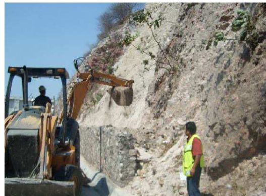
Fotografía No.75. La empresa contratista se auxilió con una retroexcavadora para realizar la remoción de material en muro alcancía.
