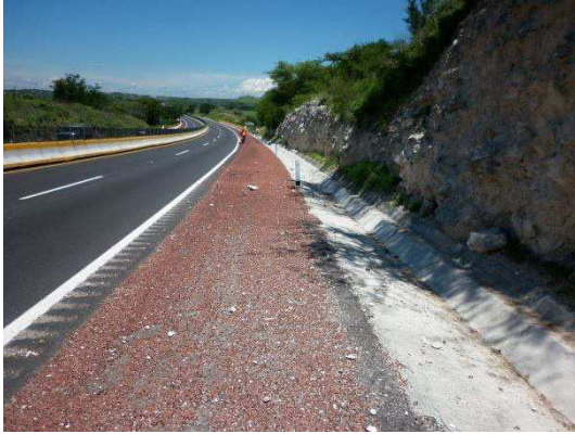
Fotografía No. 57 Se observa producto del graneado sobre la cuneta.
