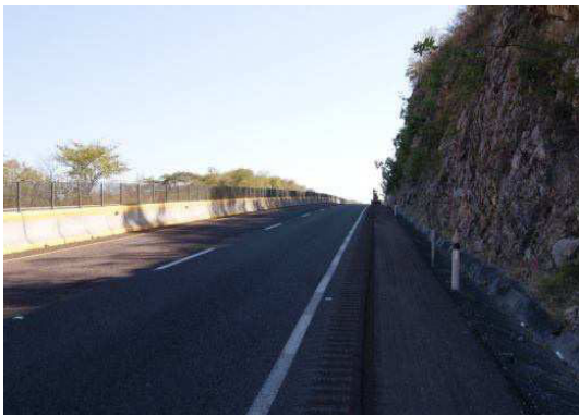
Fotografía No.1 Se observa la existencia de material rocoso, y basura.
