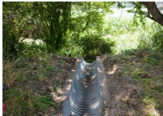
Fotografía No.62. Vista después de realizados los trabajos de limpieza y desazolve de lavaderos.
