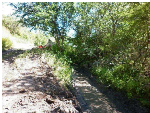
Fotografía No.67. Vista después de realizados los trabajos de desazolve de canales de entrada y salida.
