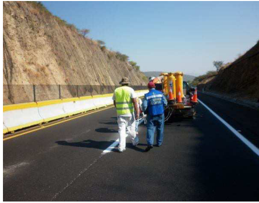
Figura No. 117. Se observa a personal de la supervisión verificando la aplicación de la pintura blanca en rayas discontinuas.
