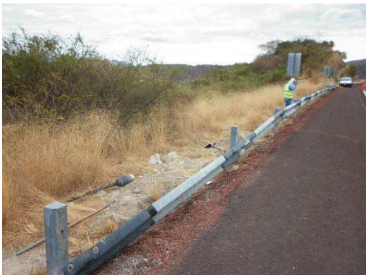
Fotografía No. 109 Se observa el estado que guardaba la defensa metálica existente.
