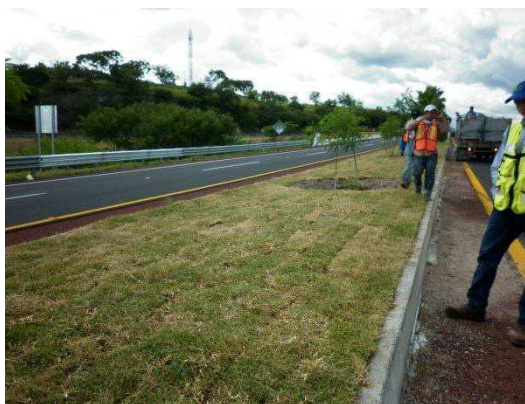
Fotografía No. 39 Vista después de terminados los trabajos de limpieza de guarnición.
