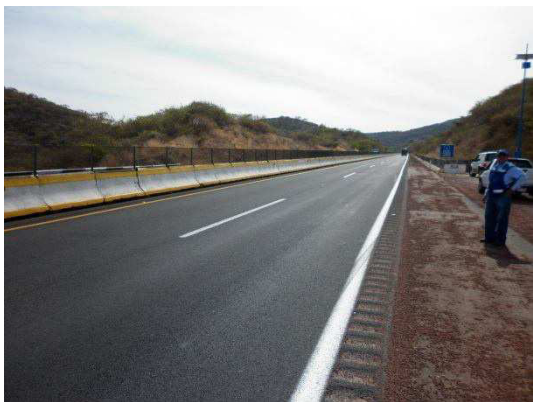
Fotografía No. 98 Vista de tramo antes de iniciar los trabajos de suministro y aplicación de pintura blanca en rayas discontinuas
