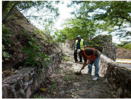
Fotografía No.69. Se observa a personal de la contratista realizando la limpieza de la contracuneta
