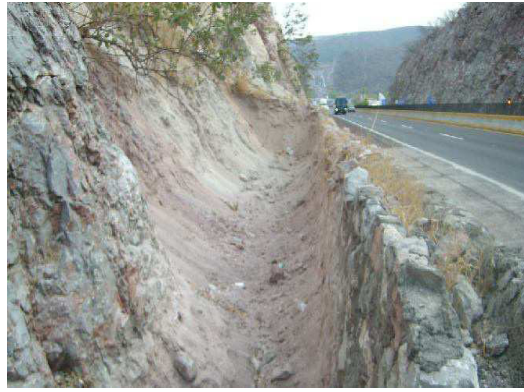
Fotografía No. 76 Vista del muro alcanzó una vez removido el material acumulado.
