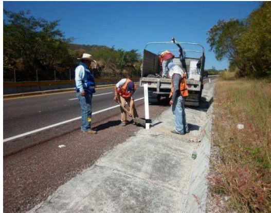
Figura No. 118, se observa a personal de la supervisión realizando la inspección y verificación del relleno con concreto hidráulico del indicador de alineamiento vertical.
