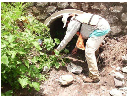
Fotografía No. 55 Se observa azolve en la salida de la alcantarilla.
