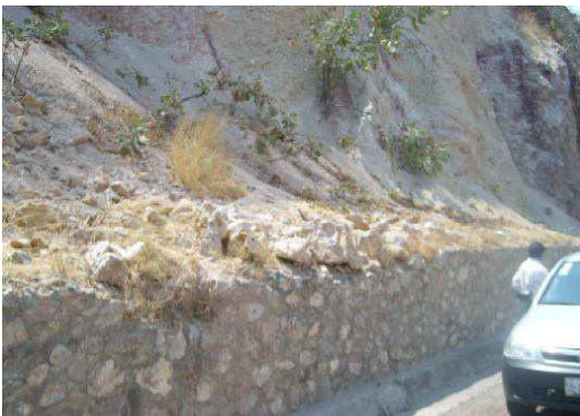
Fotografía No. 74 Se observa el material acumulado en el muro alcancía.
