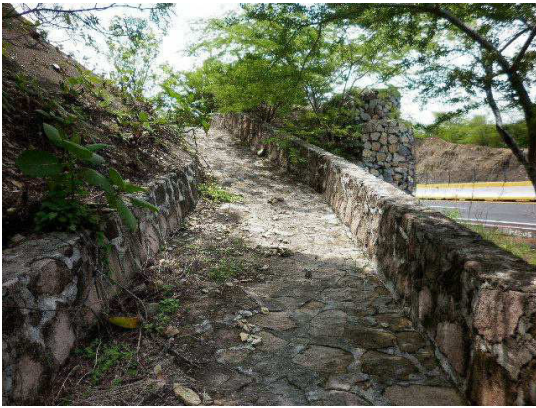
Fotografía No. 68 Se observa materia vegetal en la contracuneta.
