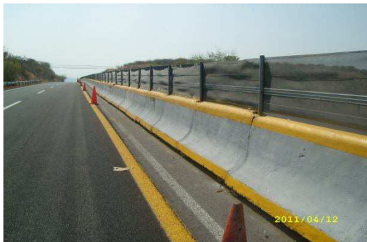
Fotografía No. 95 Tramo antes de iniciar los trabajos de aplicación de pintura en franjas de barrera central.
