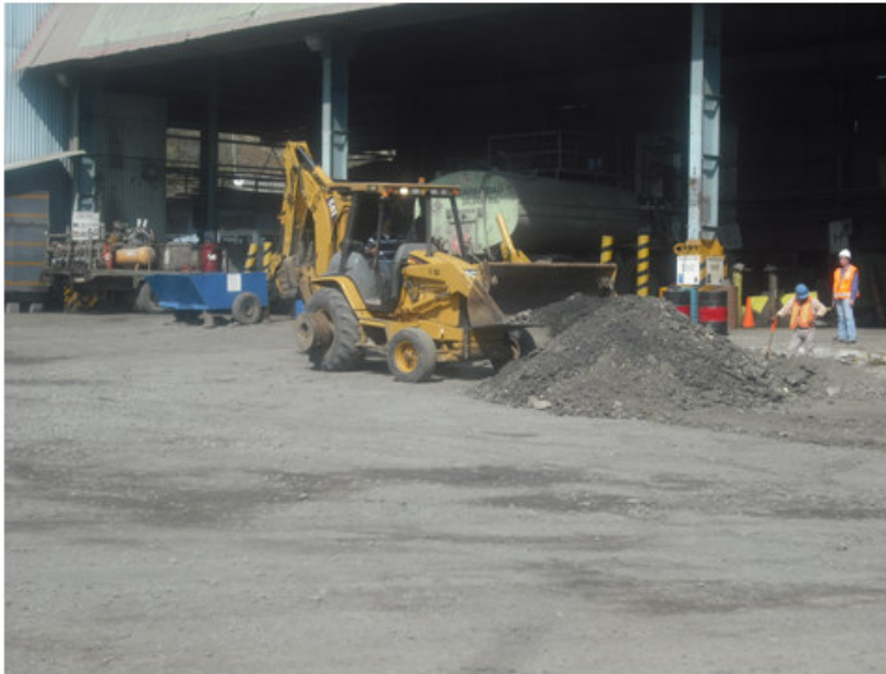
Figura 4. 14 Retroexcavadora retirando suelo contaminado del taller La Encantada (Colima) FUENTE: Reporte Peña Colorada
