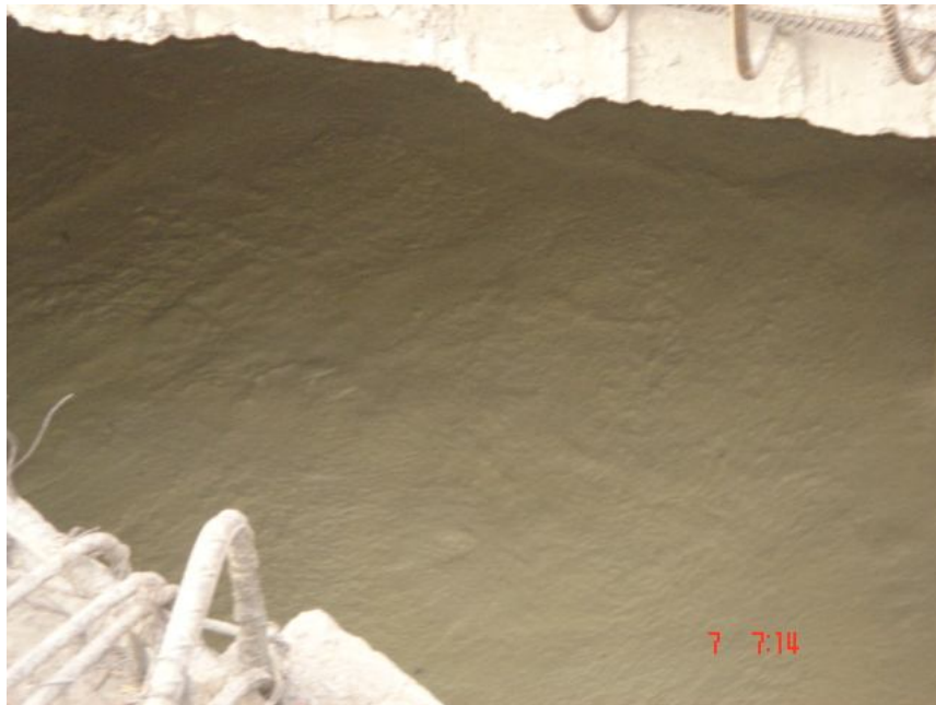
Imagen 16. Sistema de impermeabilización a base de espuma de poliuretano
