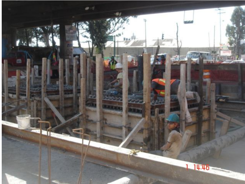
Imagen 18. Colado de ajuste de dados, colocación de tuercas de nivelación y placa de base
