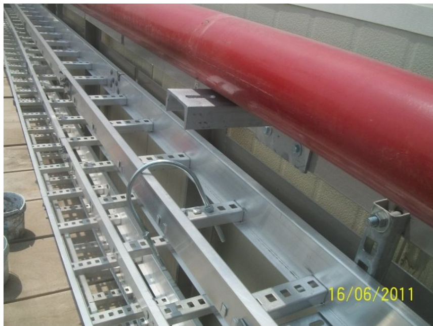
Imagen 63. Tubería contra incendio
