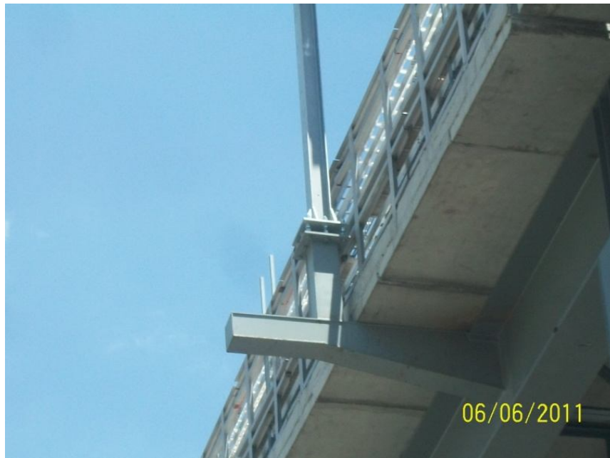
Imagen 65. Detalle bases para catenarias
