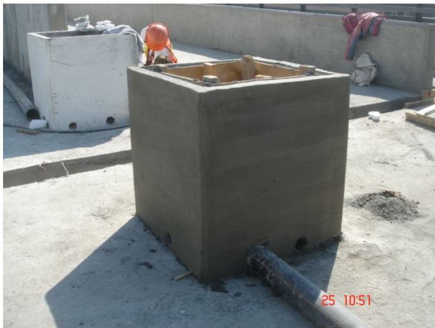
Imagen 49. Caja registro para bajada de agua pluvial
