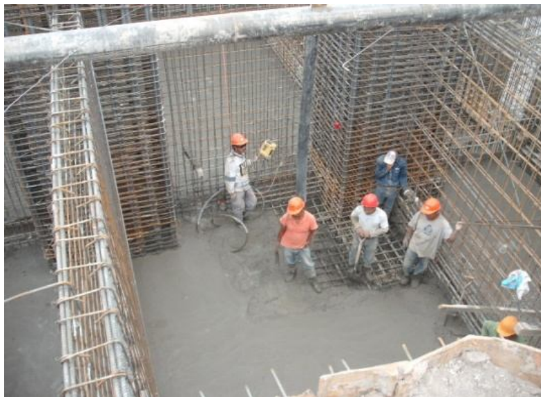
Imagen 11. Colado de losa de fondo y porción de 50 cm de muros perimetrales
