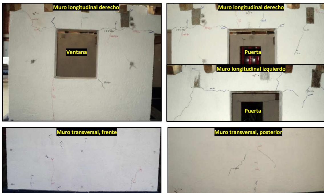
Figura 4.3 Daños en el modelo reforzado (MOD2) al final del programa de pruebas
