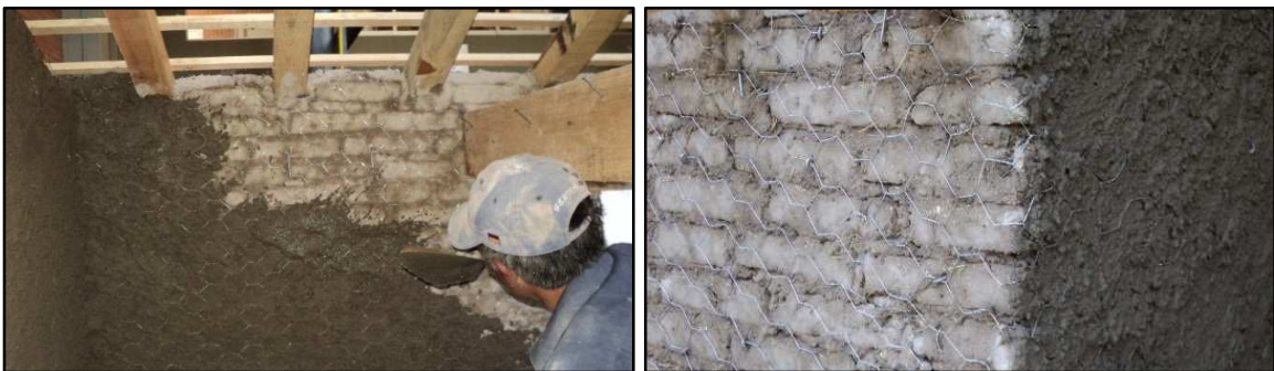
Figura 3.27 Zarpeada de mortero
