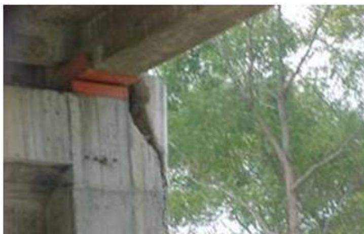
Figura 1.7. Daño en topes sísmicos del puente Coahuayana ocasionado por la ocurrencia del temblor de Tecomán del 21 de enero de 2003
