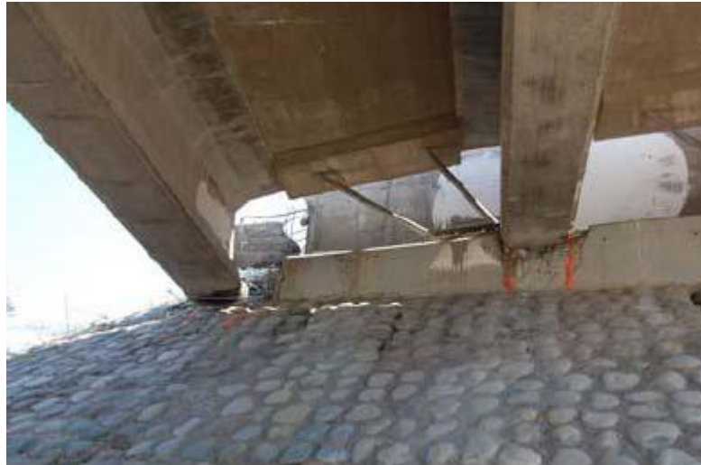
Figura 1.10. Daño en topes sísmicos del puente Las Mercedes (Chile), debido al sismo del 27 de febrero de 2010
