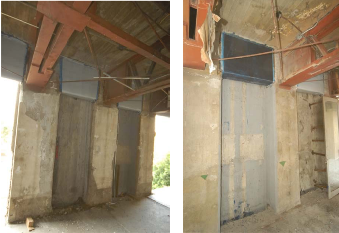
Fig 6.22 Fotografía de refuerzo de traveses existentes de los ejes “H”, “K” y “12” de la Torre Mayor con fibras de carbono
