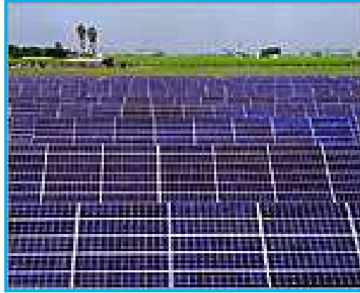
Figura.11 Sistemas Fotovoltaicos cerca de las Subestaciones
