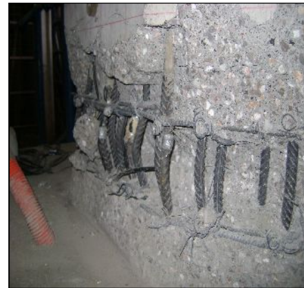
PANDEO DEL REFUERZO LONGITUDINAL C-4
