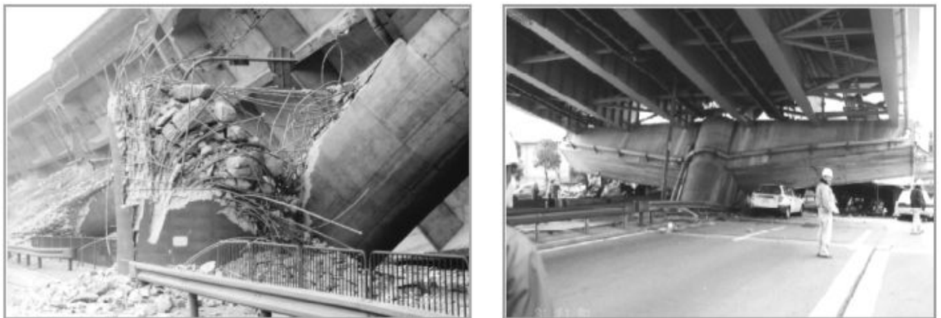
Figura 1.2 Ejemplos de fallas en columnas durante el sismo de Kobe de 1995; (izq.) Falla en las columnas del puente Hanshin por falta de longitud de anclaje, (der.) Colapso del puente Takashio por falla a cortante. Kawashima et al., (2000)
