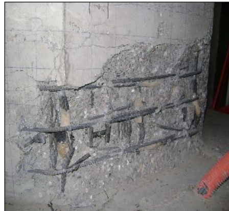
FALLA A TENSIÓN DEL REFUERZO LONGITUDINAL
