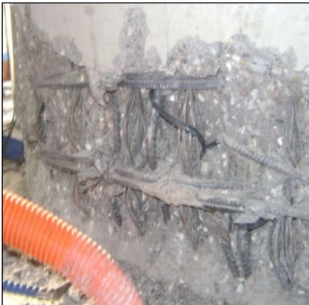
PANDEO DEL REFUERZO LONGITUDINAL
