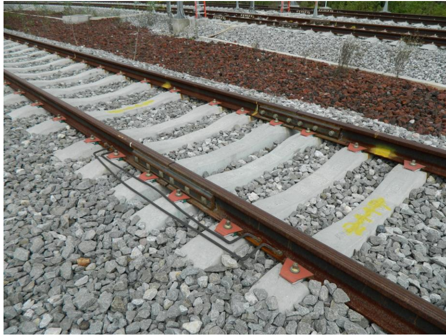
Puentes de continuidad y juntas aislantes en rieles.
