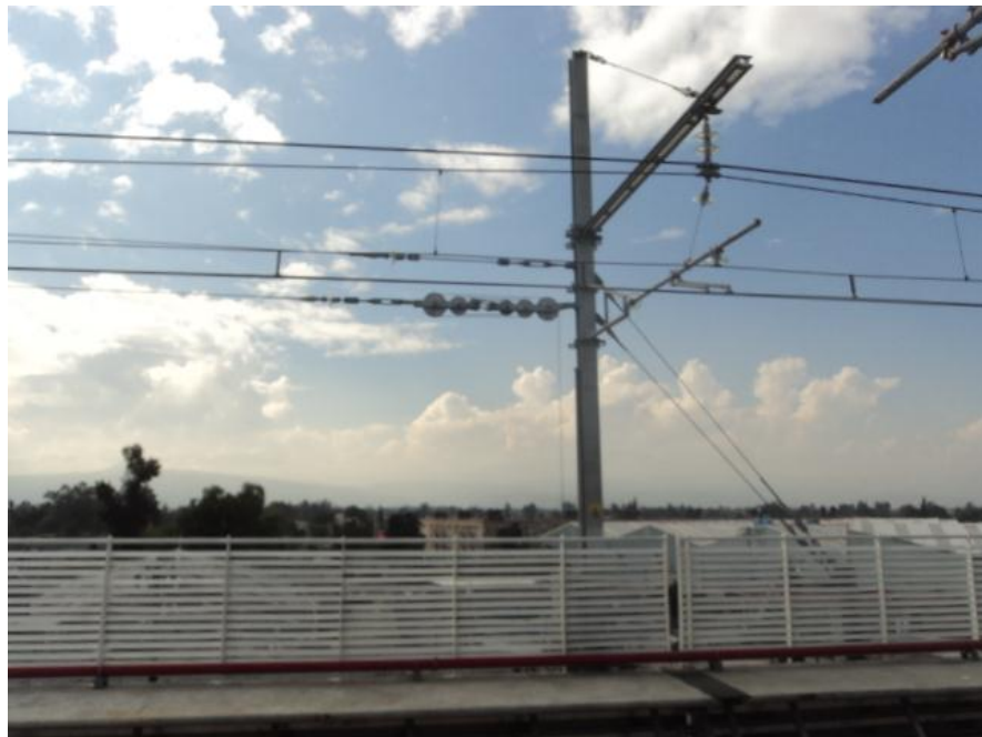
Sistema de catenaria flexible utilizado en Línea 12.
