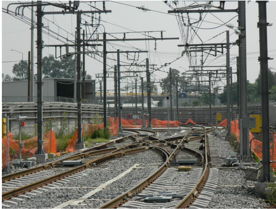
Aparatos de cambio de vía.
