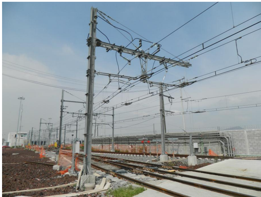
Sistema de catenaria flexible utilizado en Línea 12.
