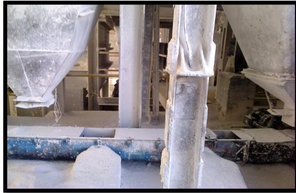
Figura 8. Transportador helicoidal y tolvas
