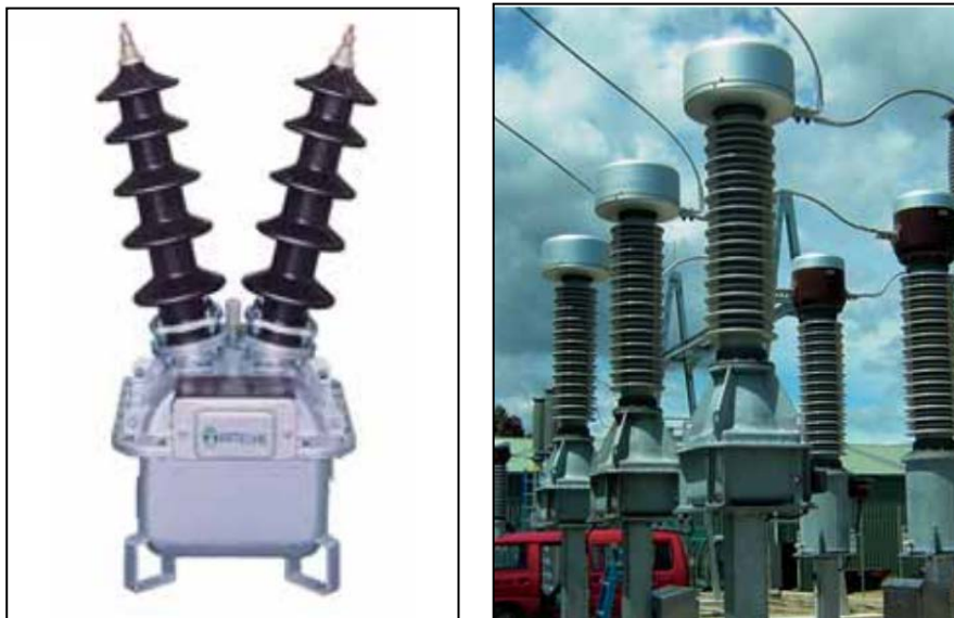
Figura 10. Transformadores de potencial tipo inductivo.
