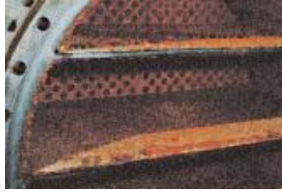
Fig. 2.5 Corrosión en sistemas de enfriamiento
