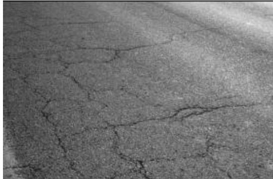
Figura 3.8 Agrietamiento en bloque (Fuente: Apuntes de ingeniería de pavimentos Ing. Fernando Sánchez Sabogal. 2012)
