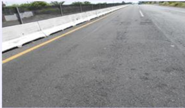
Se observa en levantamiento de deterioros el estado físico de la carpeta asfáltica
