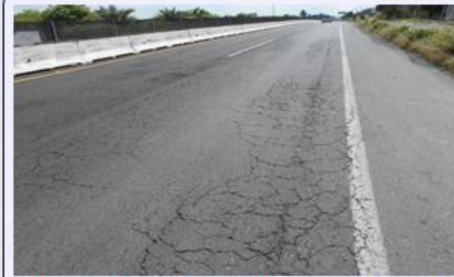
Se observa las grietas longitudinales y de piel de cocodrilo en la superficie de la carpeta asfáltica
