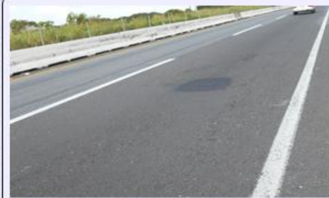
Se distingue trabajos de conservación mal realizados, como este bache tapado de manera circular
