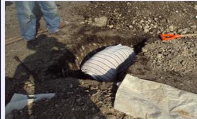
Se observa la realización de sondeos en la superficie de la carretera
