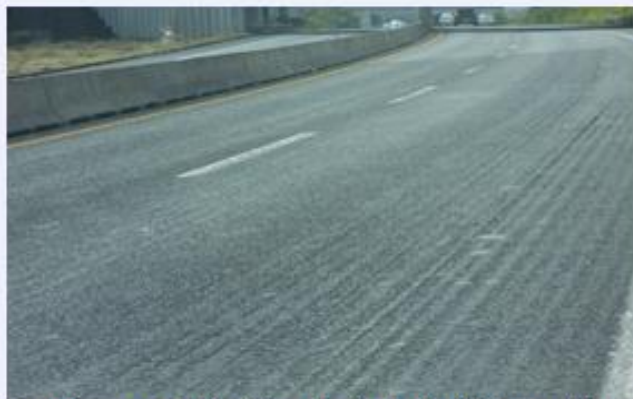
Se observa a detalle el levantamiento de deterioros tales como la pérdida de agregado grueso y roderas
