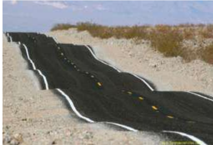
Figura. 3.1. Perfil irregular exagerado de una carretera (Fuente: Dr. Erwin Kohler, Dynatest, 2008).
