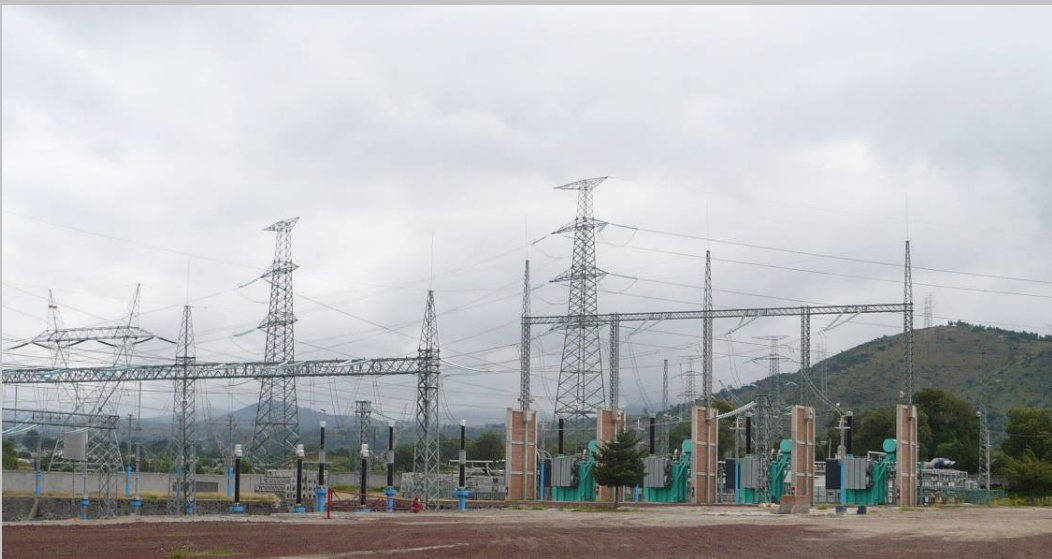
Subestación Eléctrica Texcoco de la Comisión Federal de Electricidad
