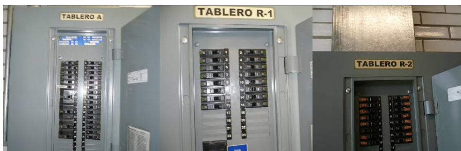
Fig. 4.11 Tablero A de 42 circuitos y derivados R1 y R2.
