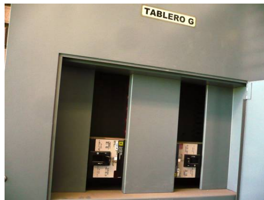
Fig. 4.10 Gabinete I-Line con Interruptores de 3x150 A. y 3x175A.
