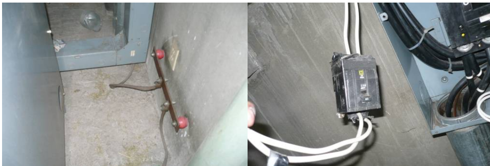
Fig. 5.13 Imagen del estado actual del área del Transformador en el Centro de Cómputo del CCH Vallejo.
