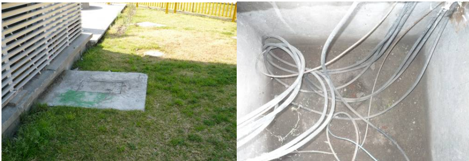
Fig. 5.2 Registro antes de llegar al Interruptor Principal.
