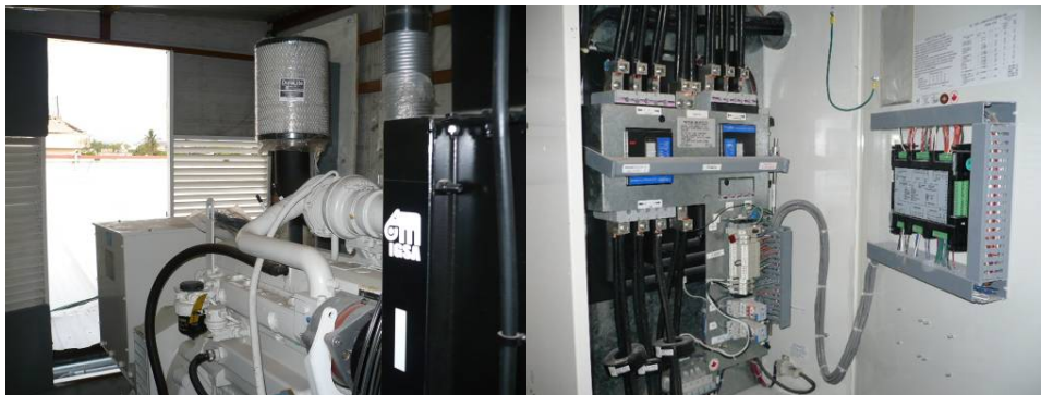
Fig. 5.6 Vista de Planta Marca IGSA de 100 KW con Tablero de Transferencia.
