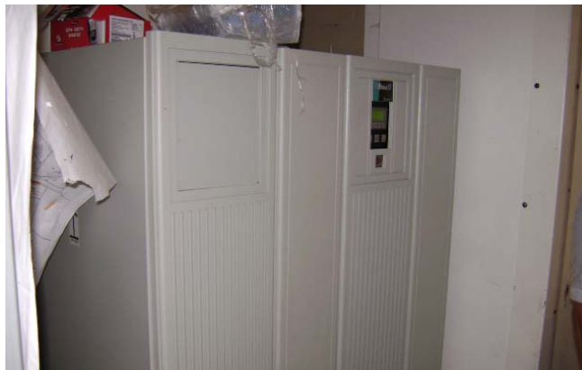
Fig. 5.12 Imagen representativa de un UPS de capacidad alta, UPS instalado en una Tienda Elektra de la ciudad de Mérida.
