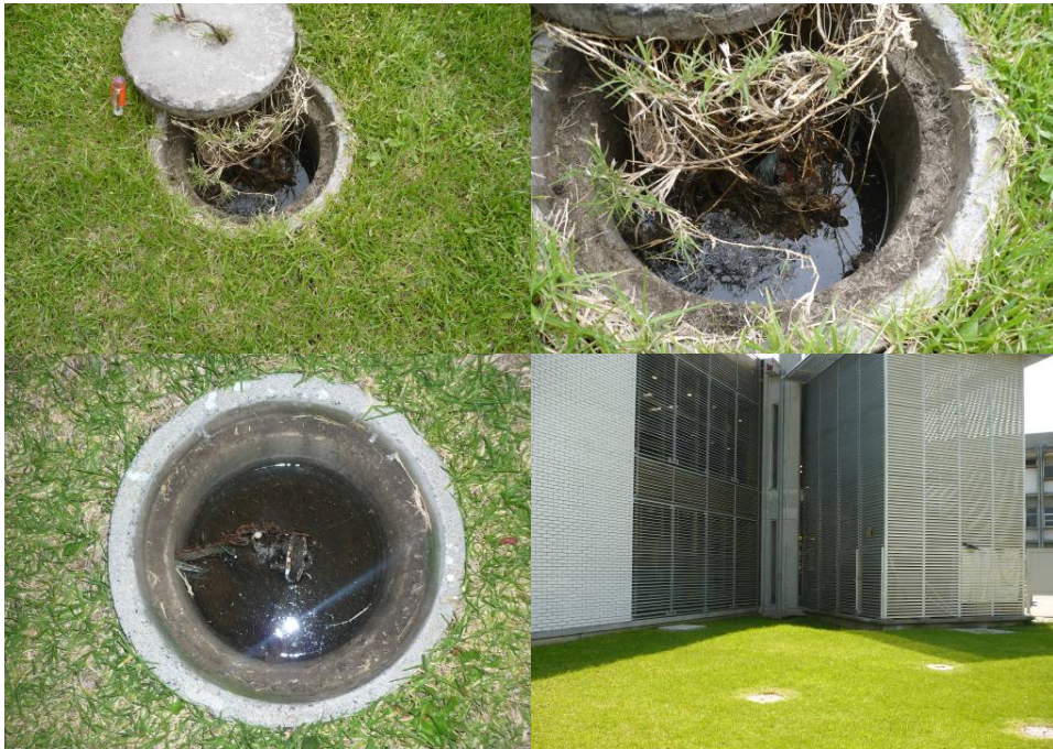
Fig. 5.15 Imagen representativa del estado actual de sistema de Tierras del Centro de Cómputo del CCH Vallejo.
