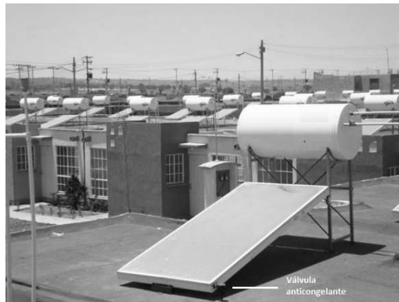
Figura 16. Calentador solar termosifón en viviendas verdes.
