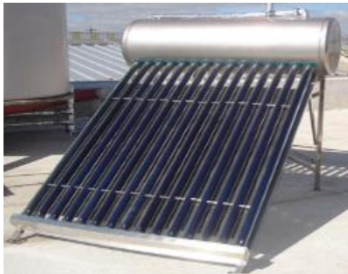
Imagen 13. Sistema de calentamiento solar de agua
