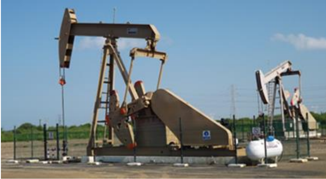
Figura 3.9: UBM Convencional en el Campo Tamaulipas-Constituciones 4 .
