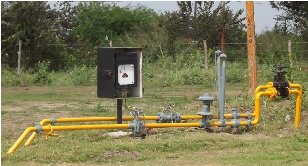
Figura 3.7: Tren de inyección con instrumentación requerida, para la operación del BNI 4 .
