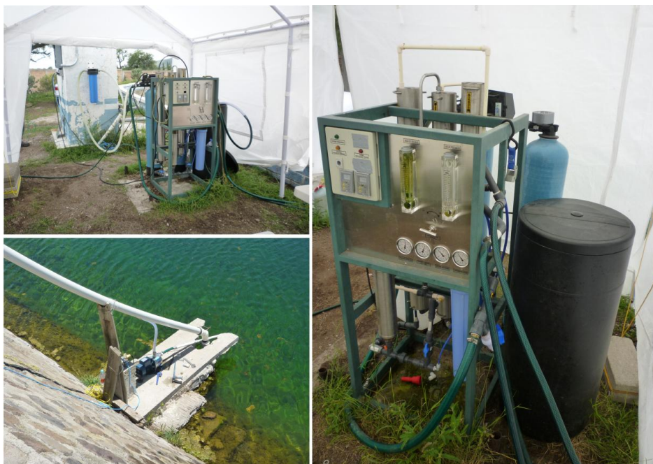
Figura 9. Módulo de membranas de nanofiltración instalado en el manantial de Cerro Colorado.
