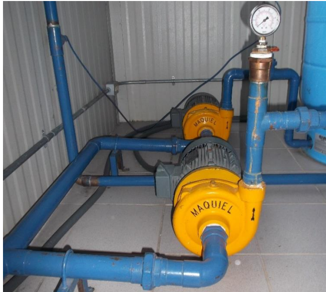
Ilustración 5.1 Equipo de bombeo para suministro de agua a mesa de laboratorio.
