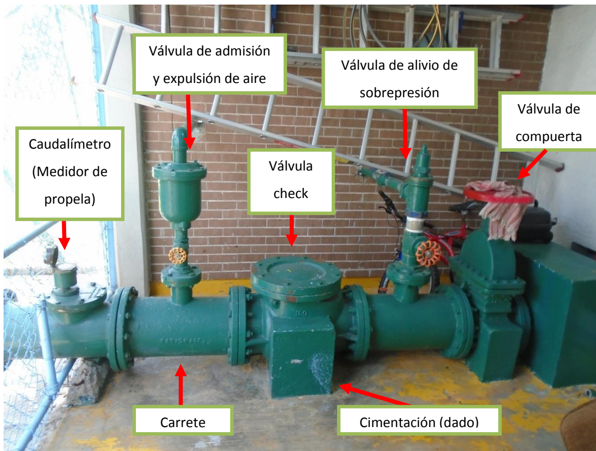
Figura 39 Equipo de bombeo, accesorios y válvulas.
