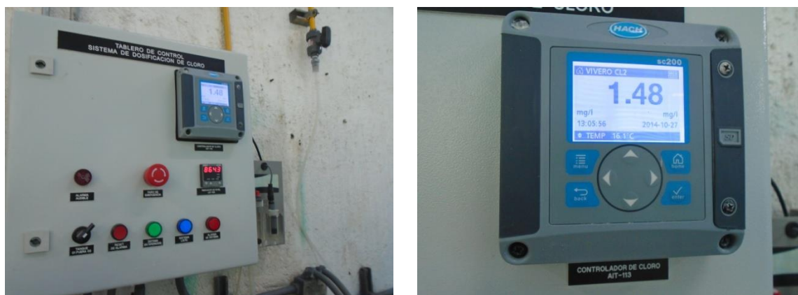
Figura 26 Equipo electrónico para dosificación del hipoclorito.
