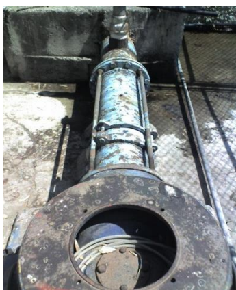
b) Pozo Multifamiliar
