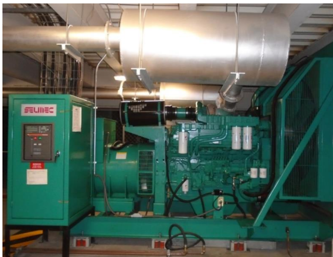
Fig. No. 15. Planta de emergencia 900 KW. SELMEC.
