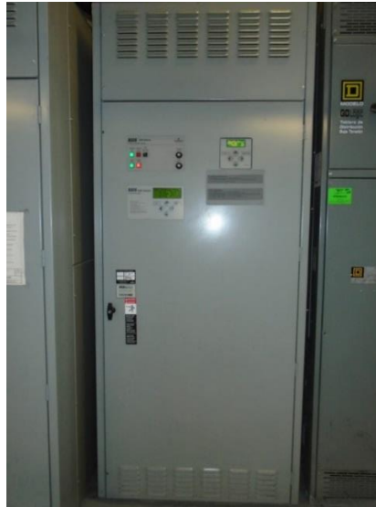
Fig. No 16. Tablero de Transferencia ASCO
