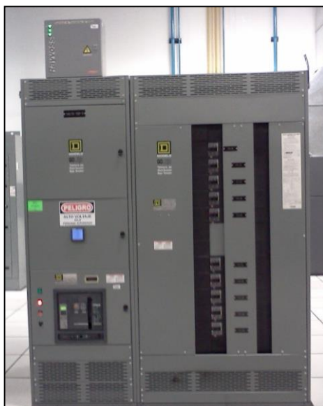
Fig. No. 17. Tablero de baja tensión. Square D.
