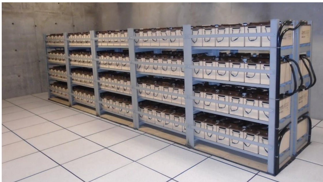
Fig. No. 22. Banco de 120 baterías. Ritar
