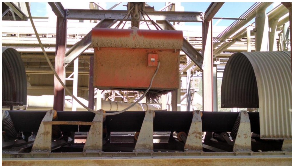
FIG. 2.45 Electroimán instalado en la banda 5a
