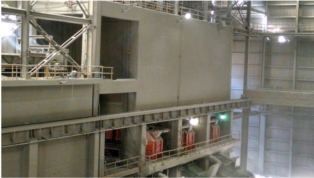
FIG. 2.12 Tolvas de compensación y alimentadores a cribas de quebradoras secundarias
