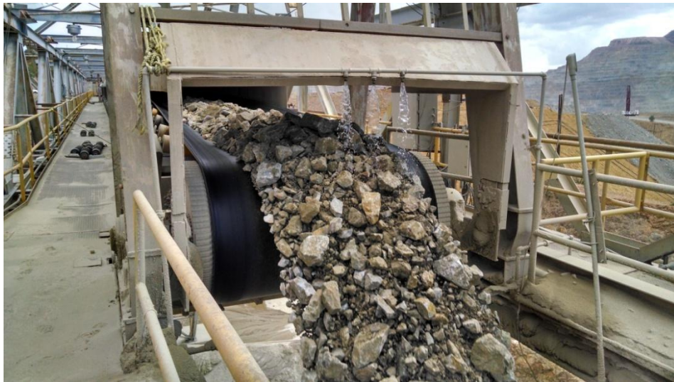
FIG. 2.34 Descarga del mineral de la banda 2 al almacén de gruesos
