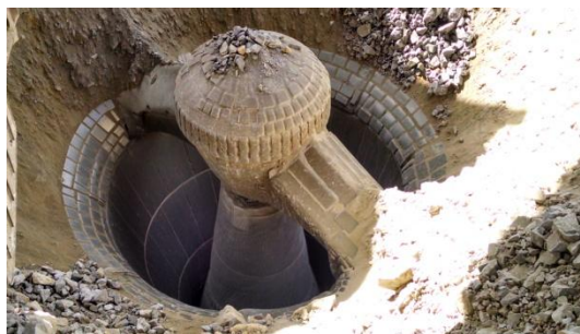
Quebradora giratoria de campana operando en trituración primaria en “La Caridad”
