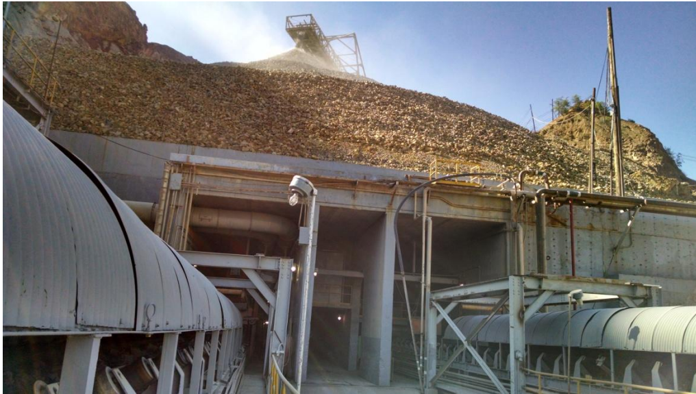
FIG. 2.2 Salida de las bandas 3a y 3b del almacén de gruesos
