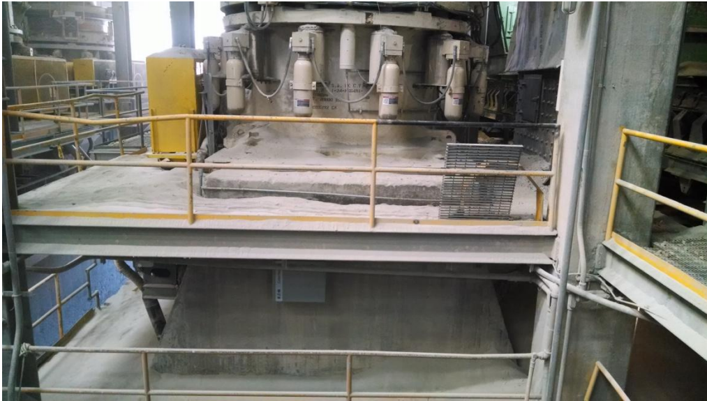
FIG. 2.62 Pistones hidráulicos de quebradora secundaria
