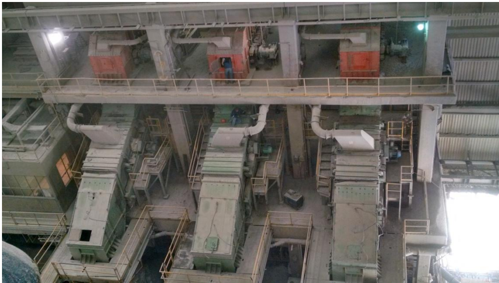
FIG. 2.68 Vista de las 3 cribas vibratorias instaladas en el lado A de la planta de trituración
