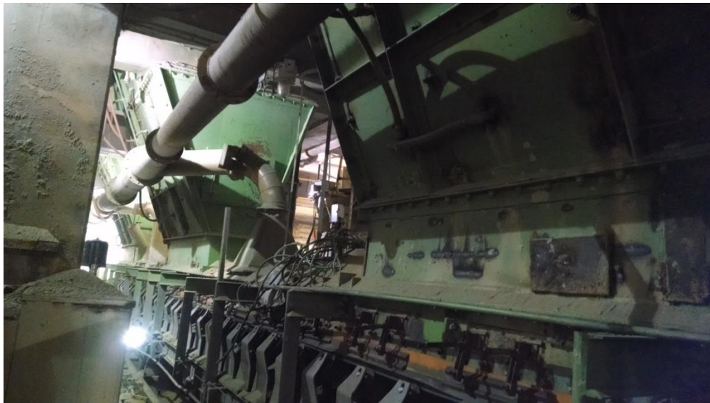
FIG. 2.52 Descarga de finos de cribas en banda 9a
