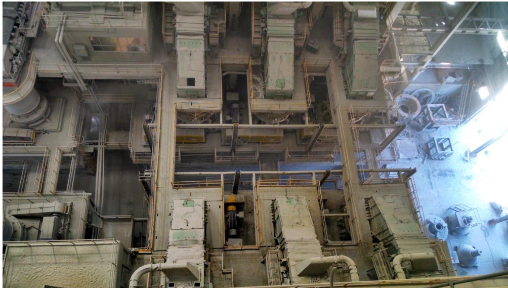
FIG. 2.60 Vista aérea de las dos secciones de tritución secundaria
