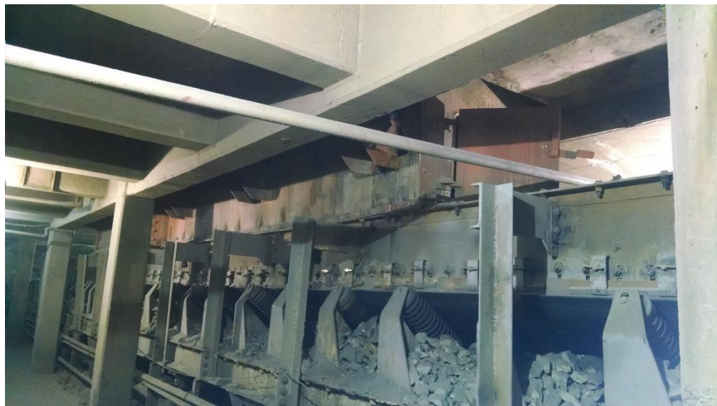
FIG. 2.5 Chutes de descarga en banda 3a
