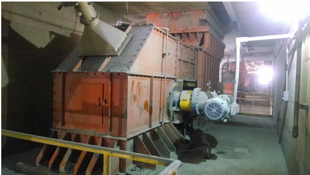
FIG. 2.3 Alimentadores de placas del almacén de gruesos a banda 3a
