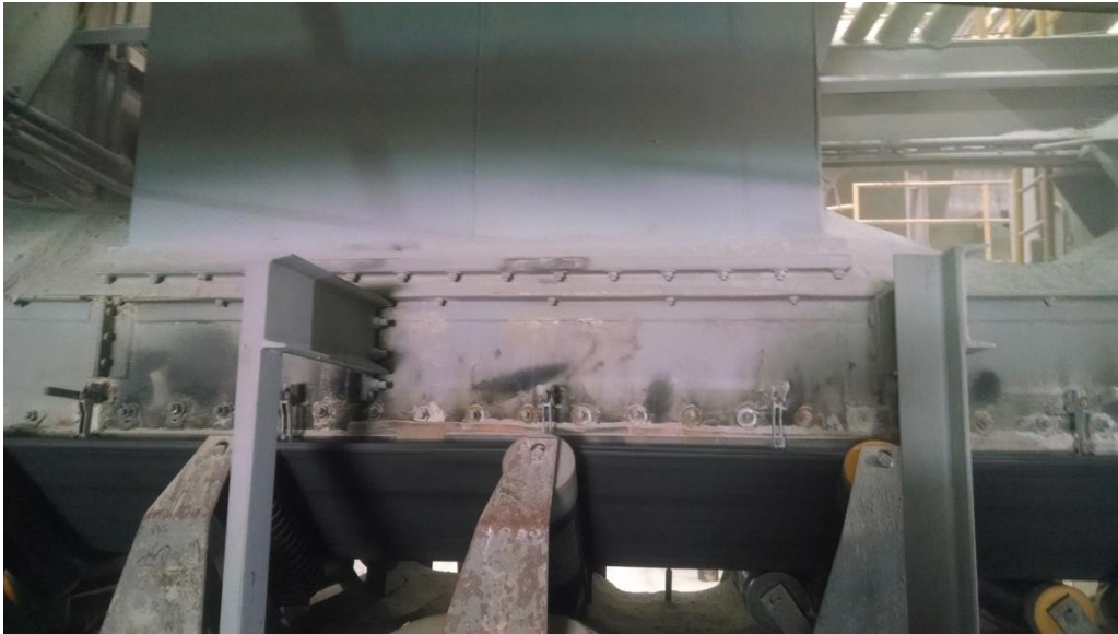
FIG. 2.24 Descarga de gruesos en banda 5a
