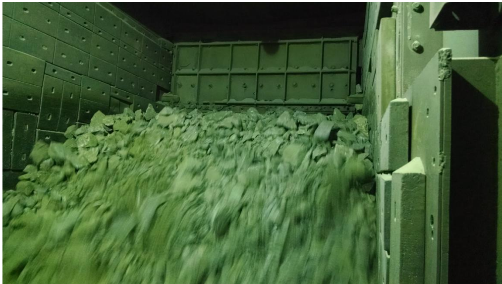
FIG. 2.29 Chute de transferencia del alimentador a la banda 1
