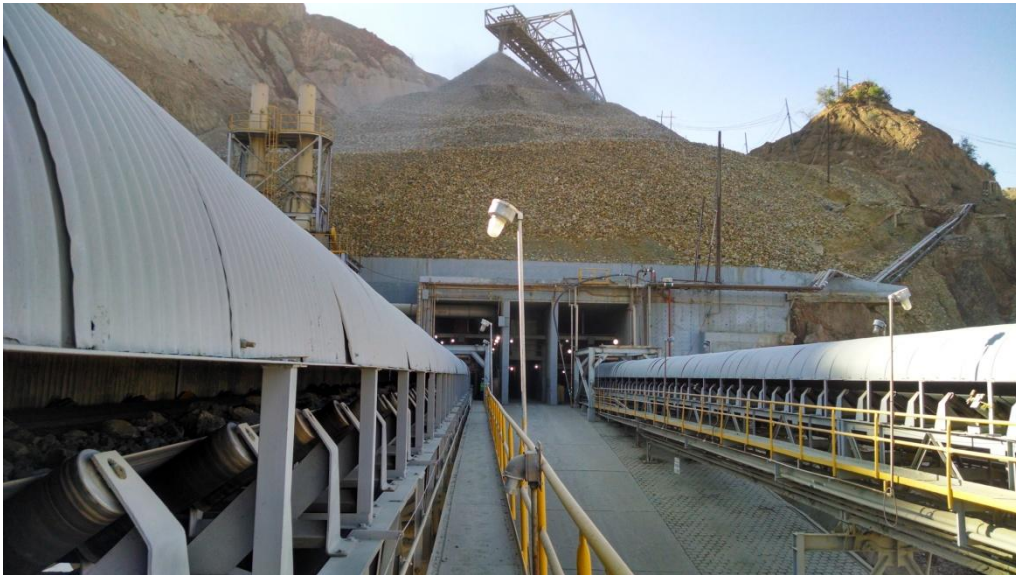
FIG. 2.40 Bandas 3a y 3b con mineral del almacén de gruesos a planta de trituración fina
