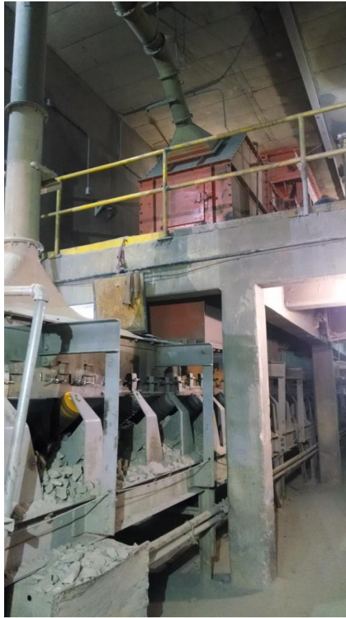
FIG. 2.4 Chute de descarga a banda 3a
