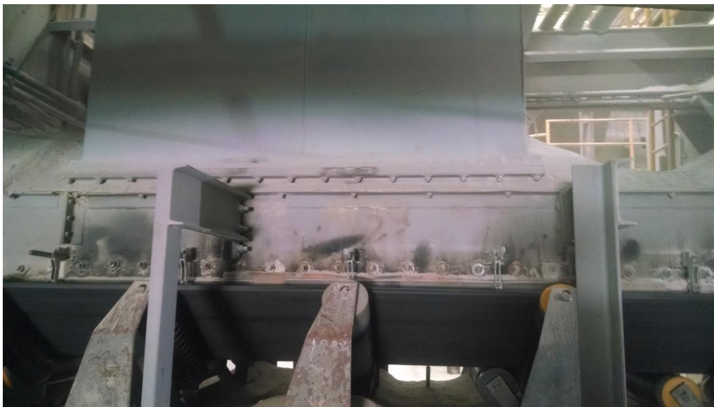
FIG. 2.43 Descarga de gruesos de quebradoras secundarias en banda 5a
