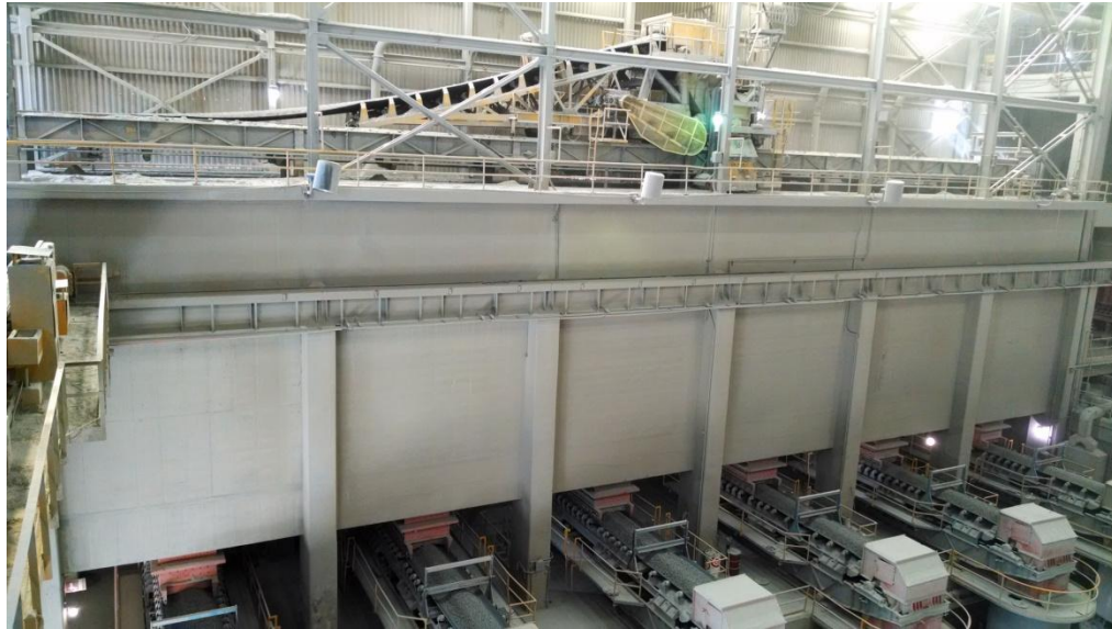
FIG. 2.26 Tolvas de compensación de quebradoras terciarias
