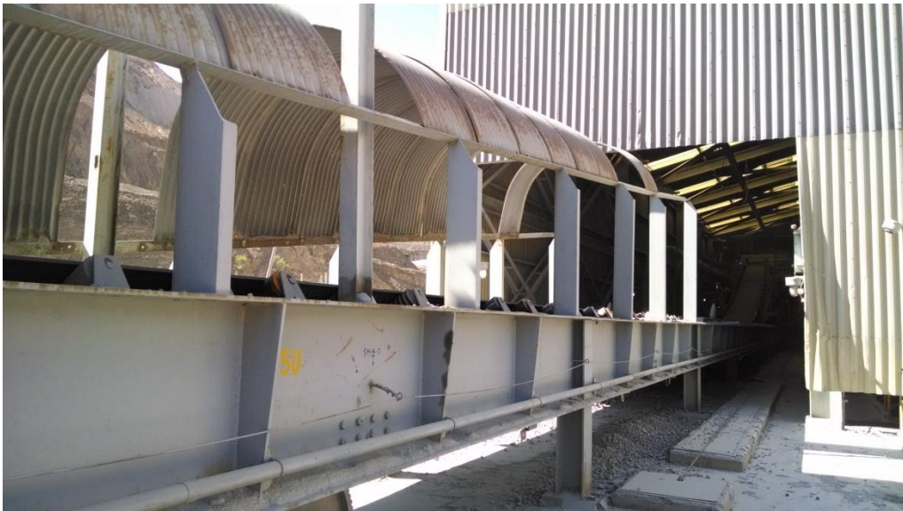
FIG. 2.48 Banda 7a de área 25 a planta de tripper 7a
