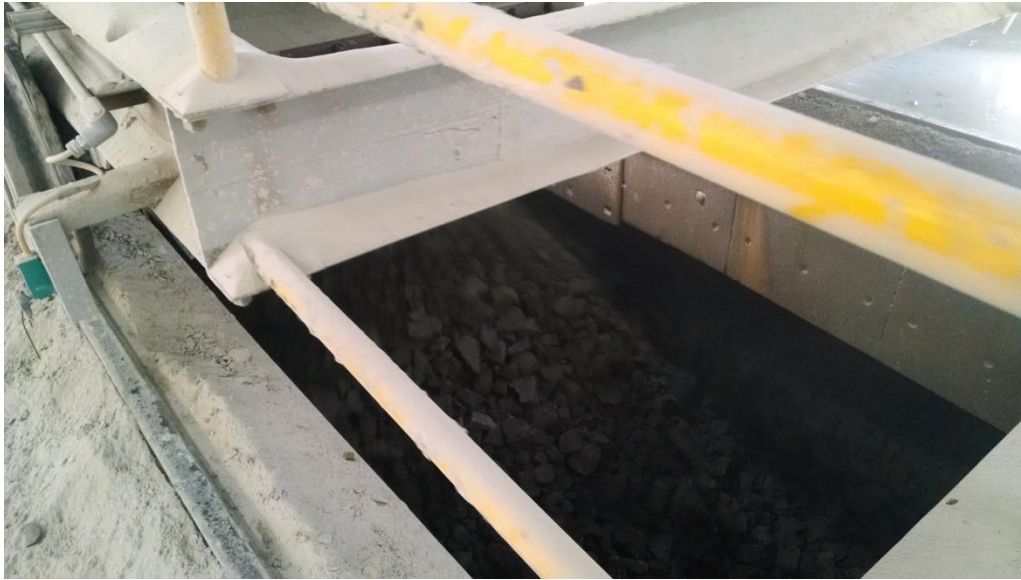
FIG. 2.16 Descarga de mineral del tripper 4b a la tolva de compensación de la quebradora secundaria
