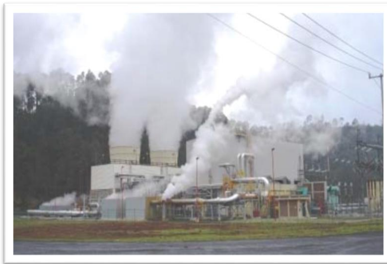
Ilustración 6 Central Geotermoeléctrica Los Azufres
