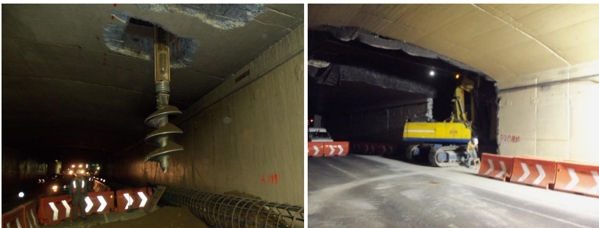
Figuras 42 y 43 .Problemas de perforación. Pilas en Arenas
