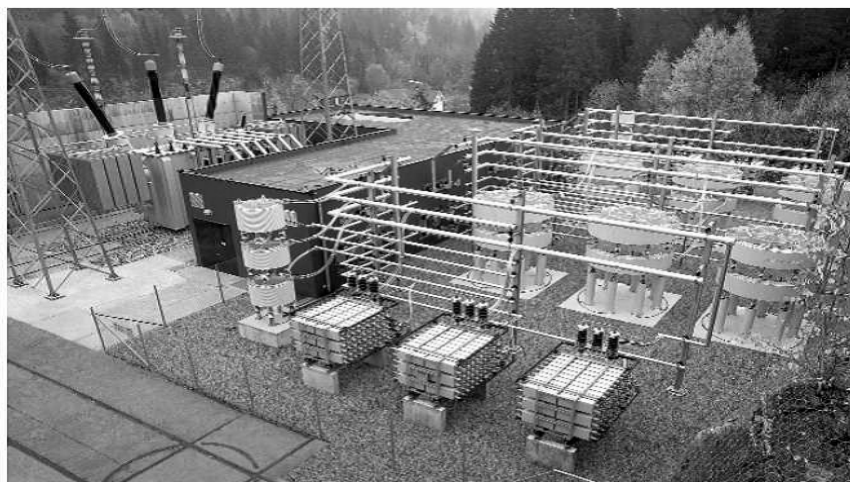
Figura 3.20 SVC de 420 kV en Sylling, Noruega.
