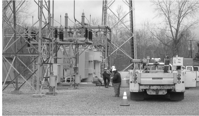
Figura 4.12 Subestación Sullivan, Tennessee, USA.
