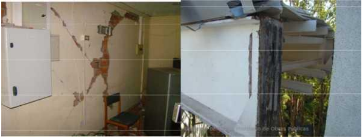
a) Falla muro
