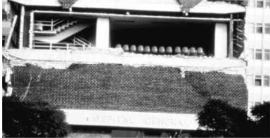
Figura 10.7 Falla de un muro en un hospital.
