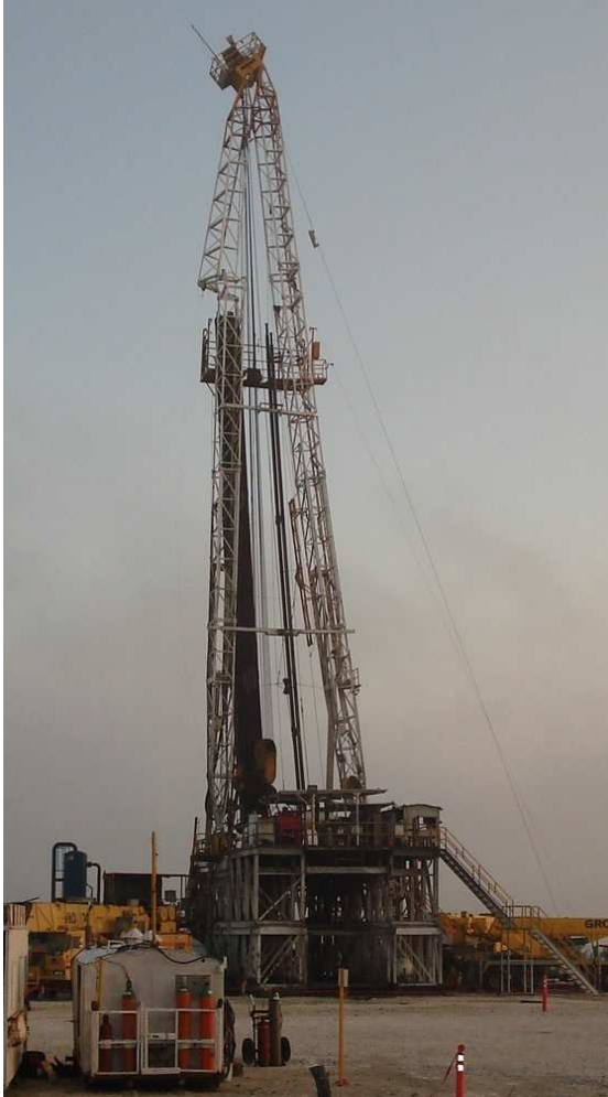
Figura 6. Colapso de la estructura FV-405.
