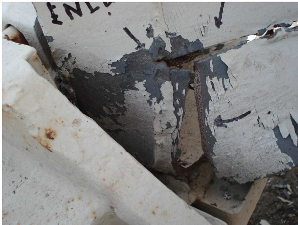
Figura 11a. Falla en zona aledaña al cordón
