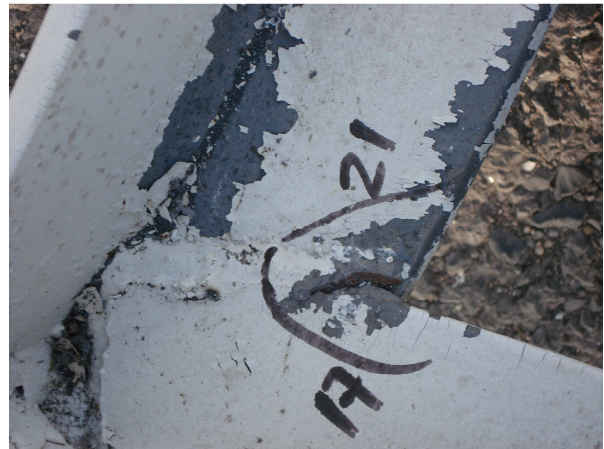
Figura 11b. Falla en el cordón
